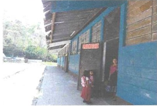
Foto 2: Sustitución de estructura de techo que se encuentran oxidadas que ameritan mantenimiento.
